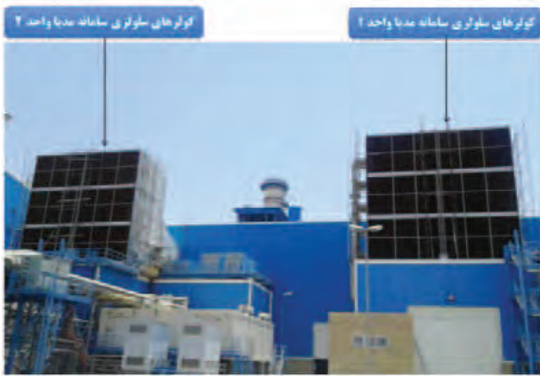
شکل ۷ نمای از کولر نصب شده بر روی مولدهای گازی ۲، ۱ نیروگاه سیکل ترکیبی سرو (چادرملو)
